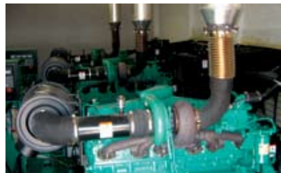
No alto, imagem dos grupos geradores instalados.
